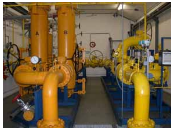
Innenansicht der Zollmessstation
