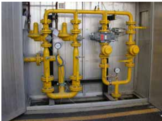
Versorgungsstation eines Betriebes
